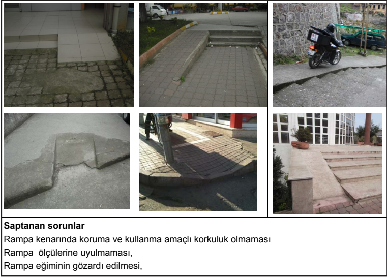
Çizelge 5: Engelli kullanımına uygun olmayan rampalar
