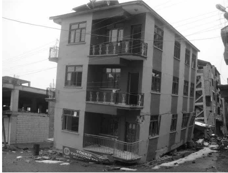
Şekil 8 Yumuşak kat / Zayıf kat
