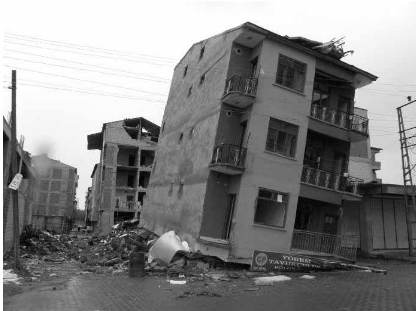
Şekil 9 Van Erciş'te yumuşak kat sebebiyle zemin kat kolonları göçmüş ağır hasarlı yapı.
