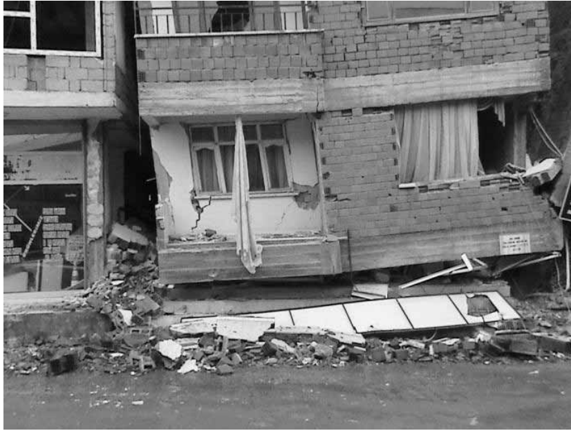
Şekil 11 Van Erciş'te çarpışma etkisi ve yumuşak kat sebebiyle ağır hasar ve göçen binalar.
