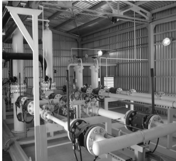
Şekil 1. Rms - A İstasyonu
