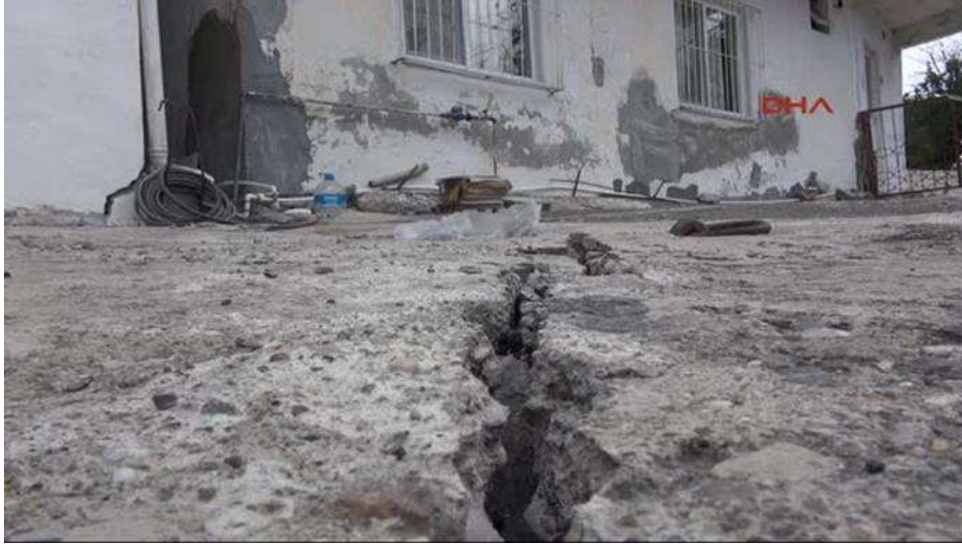
Şekil 1. Zonguldak'ın Kozlu ve Kilimli ilçelerinde maden faaliyetleri nedeniyle bazı evlerin tabanlarında çökme, duvarlarında çatlaklar oluştu. ( https://www.haberler.com/tasman-evsiz-birakti-6303575-haberi/ ).
