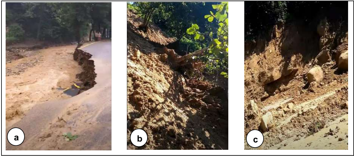
Şekil 13. Küpler Deresi kenarında Çaycuma Formasyonunda gelişen heyelanlardan görüntüler (a-Yol çökmesi, b-heyelan, c-Kaya yuvarlanması)
