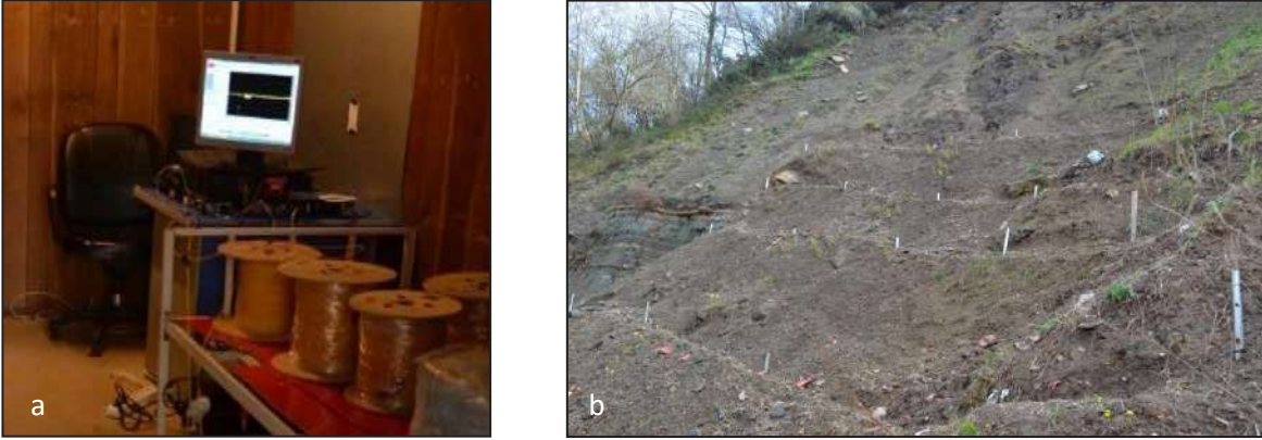
Şekil 2. a) Fiber optik sistemin konteynır içindeki görünümü, b) sabitleme noktaları ve kablo seriminin yakından görünümü.
