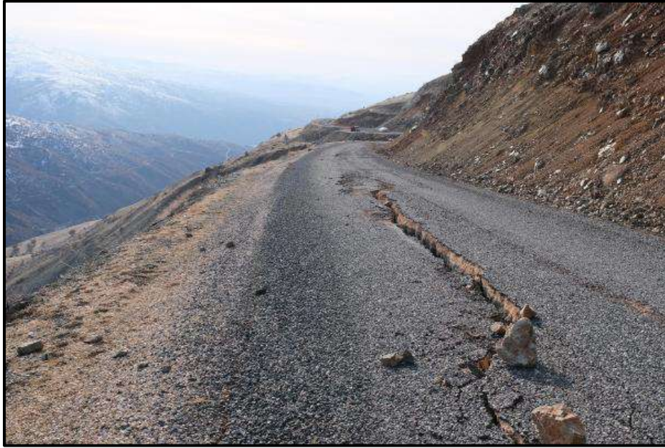
Şekil 14. Depremden Sonra Yollarda Oluşan Yarıklar (Kaynak: Url-24)
