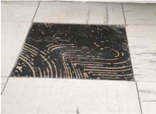
Şekil 10. Marley vinil yer döşemesi
