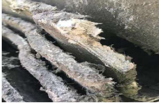
Şekil 6.b Çatı kaplaması eternit içinde asbest lifleri
