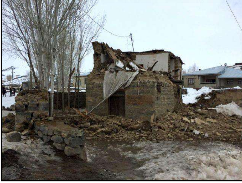
Şekil 18. Depremden Sonra Yıkılan Konutlar (Kaynak: Url-32)
